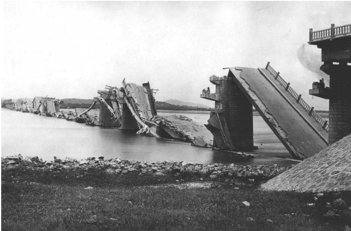
Infolge eines Erdbebens eingestürzte Straßenbrücke (Highway Peking – Yuguan, China).
