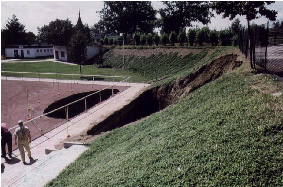
Tagbruch am Sportplatz in Mendig (Eifel).
