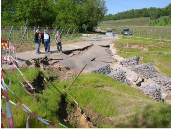
Rutschung bei Bad Bergzabern, 2010 (Foto: M. Alberti, LGB, 17.05.2010)
