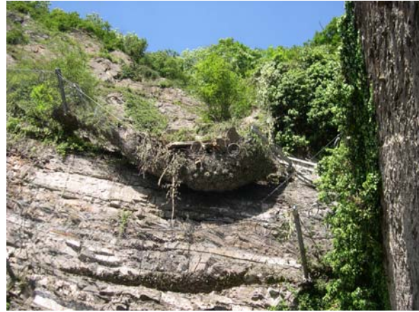
Felssturz in Rückhaltezaun bei Bad Ems, 2009 (Foto: M. Alberti, LGB, 20.05.2009)
